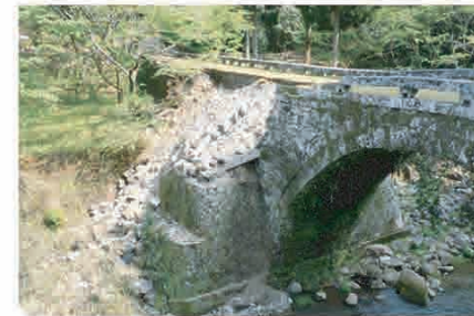
崩れた八勢目鑑橋
